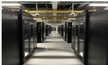
上海自贸区机房实施照明系统能效管理。（数据中心供图）
