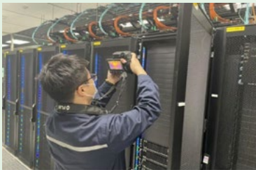
北京稻香湖机房进行热成像扫描。（数据中心供图）
