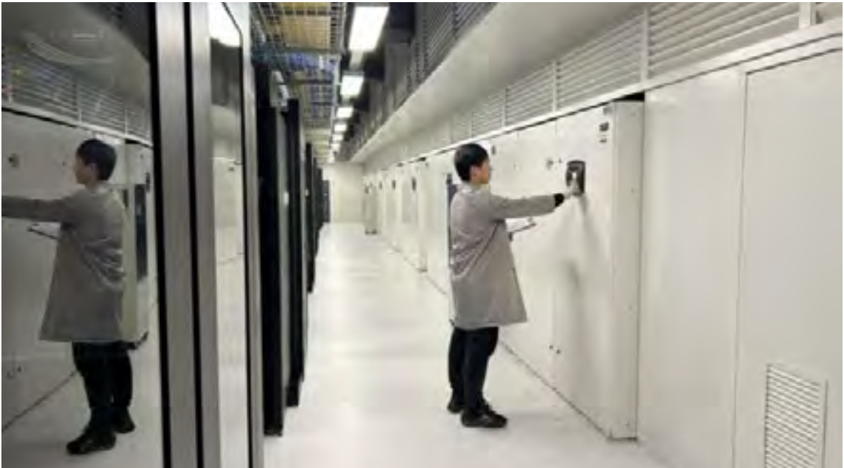
✦ 本行数据中心持续推进绿色用能。（数据中心 供图）
